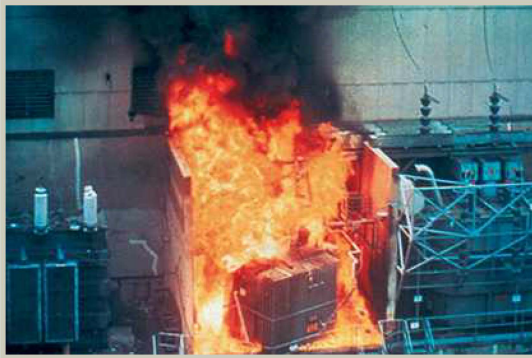
▲ 절연유를 사용하는 유입변압기의 화재사고가 폭발 사고로 전개되어 인명 및 재산피해 초래
